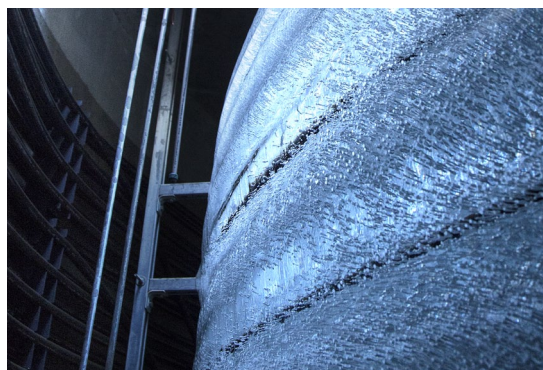
Wnętrze magazynu energii
