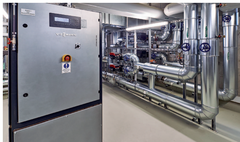
Moduł kogeneracyjny Vitobloc 200 wytwarza prąd do napędu pompy ciepła.
