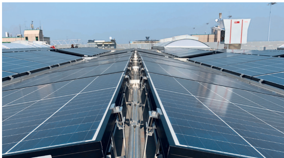
„Dach energetyczny“ z kombinacją modułów fotowoltaicznych z absorberami solarno-powietrznymi
