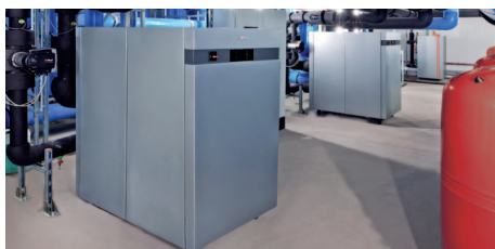
2 pompy ciepła Vitocal 300-G Pro po 120 kW, na tylnym planie 1 gazowy kocioł kondensacyjny Vitocrossal 300 jako kocioł obciążenia szczytowego.
