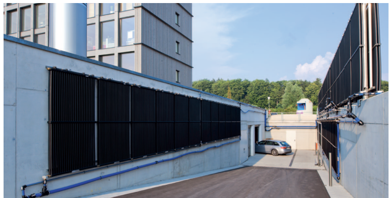
Zajmujące mało miejsca absorbery solarno-powietrzne-typu plot energetyczny na wjeździe do garażu podziemnego
