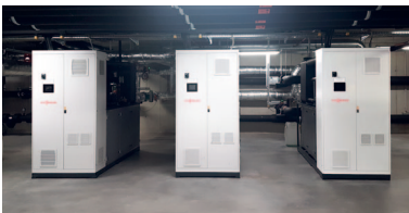
Duże pompy ciepła Viessmann osiągają moc po 520 kW.
