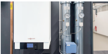
Gazowy kocioł kondensacyjny Vitodens 200-W pokrywa obciążenia szczytowe.
