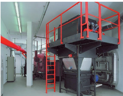
System oczyszczania spalin z separatorem pyłu, odpylaczem multicyklonowym i filtrami: elektrostatycznym oraz tkaninowym
