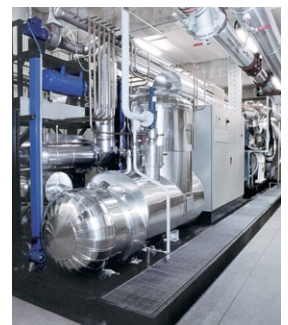
Instalacja ORC do wytwarzania energii elektrycznej
