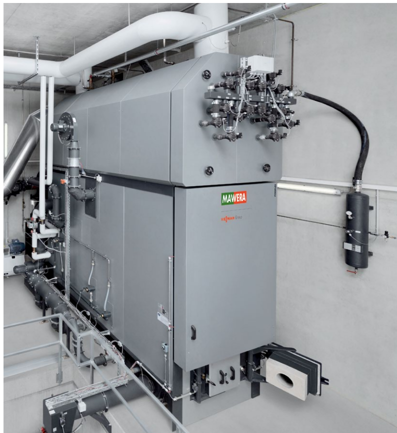
Ciepłownia w Gräfelfing z kotłem na biomase (z prawej) i kotłem do wytwarzania wody gorącej dla pokrycia obciążeń w szczycie
