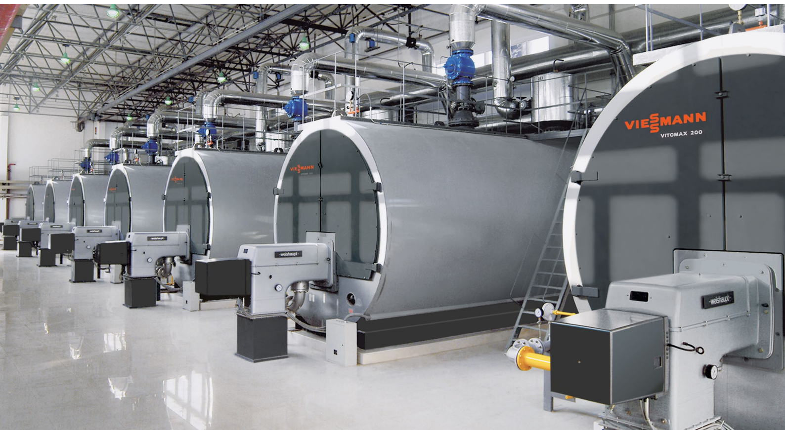
Kocioł z palnikami gazowymi do wytwarzania gorącej wody
