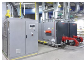
Agregat kogeneracyjny (z lewej) w kąpieliskowym raju. W razie po- trzeby dwa kotły Vitoplex pokrywa- ją obciążenie w szczycie.
