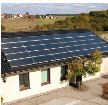
Kolektory Vitosol 100-FM ustawione poziomo na dachu.
