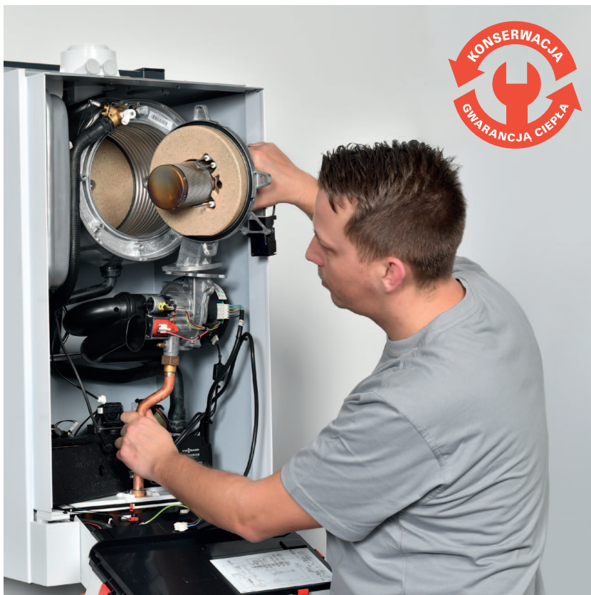
Standardowo specjaliści serwisowi sprawdzają wszystkie elementy systemu pod kątem zanieczyszczeń i zużycia poszczególnych podzespołów.
