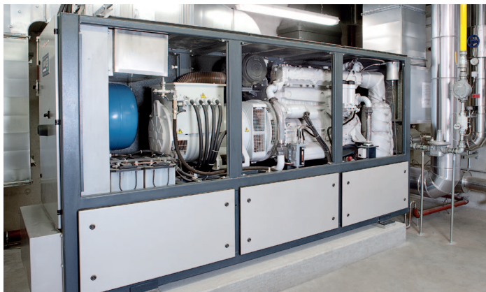
Vitobloc 200 EM-140/207 w szpitalu św. Augustyna w Düren
