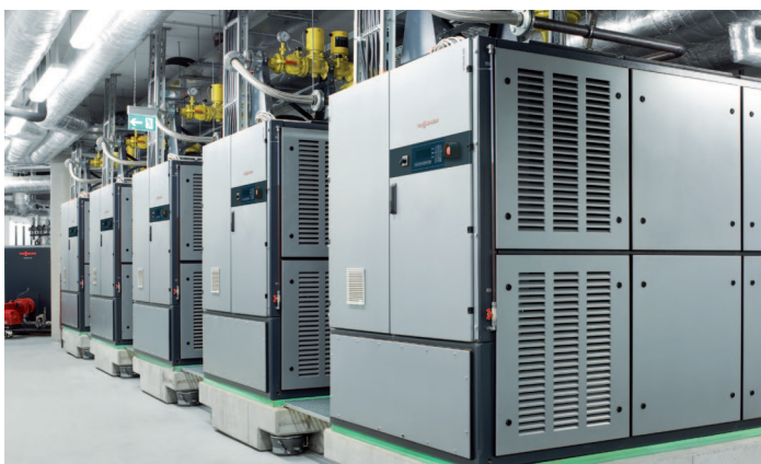
Pięć modułów kogeneracyjnych Vitobloc 200 w budynku administracyjnym niemieckiego ubezpieczyciela Deutsche Gesetzlichen Unfallversicherung
