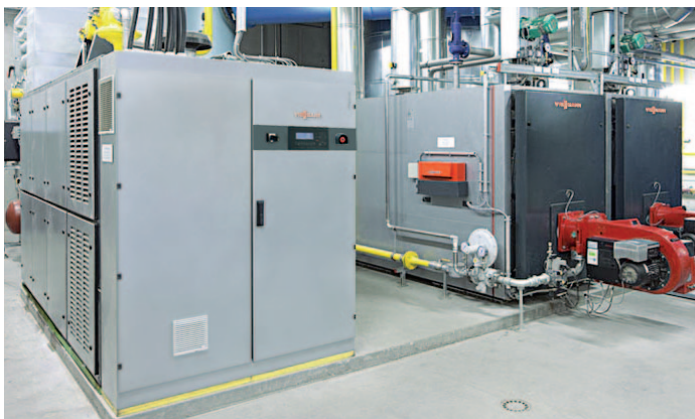
Moduł kogeneracyjny (po lewej) w aquaparku Badeparadies Schwarzwald, dwa kotły Vitoplex zasilają w razie potrzeby obciążenie szczytowe
