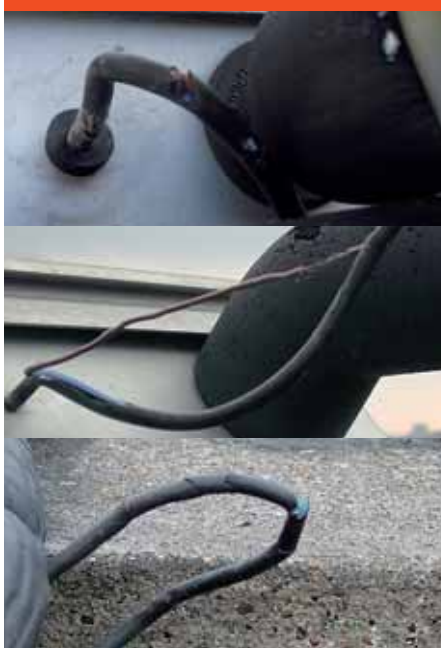
Rys. D.2.1–1 niechronione przewody czujnika kolektora
