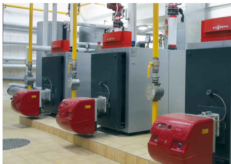
System ogrzewania z trzema kotłami Vitoplex 200, o mocy 270 kW każdy, w układzie kaskadowym
