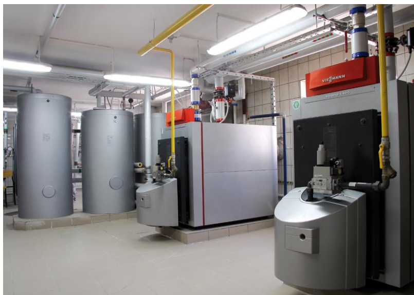
System ogrzewania z dwoma kotłami Vitoplex 300, o mocy 170 kW każdy, w układzie kaskadowym
