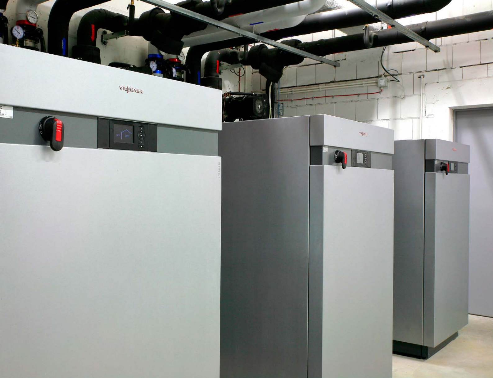
Instalacja trzech pomp ciepła Vitocal 300-G Pro o łącznej mocy 540 kW w Europejskim Centrum Edukacji Geologicznej w Kielcach
